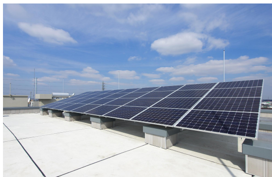
太陽光パネル(桶川市役所／埼玉県)
