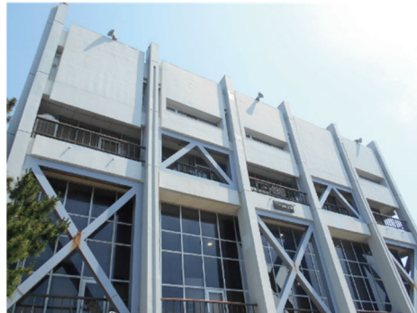
本庁舎の耐震ブレース
