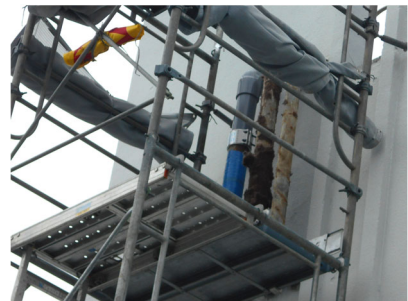
配管設備の老朽化
