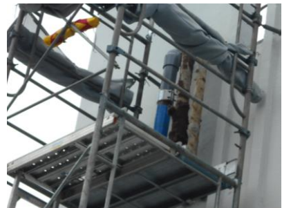
配管設備の老朽化
