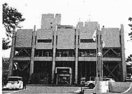
本庁舎の耐震ブレース
