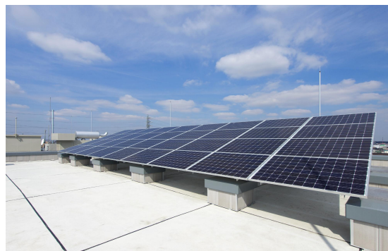
太陽光パネル(桶川市役所／埼玉県)
