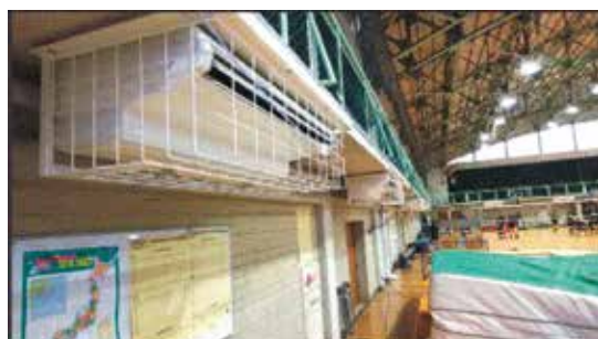
他市の学校体育館の空調設備
