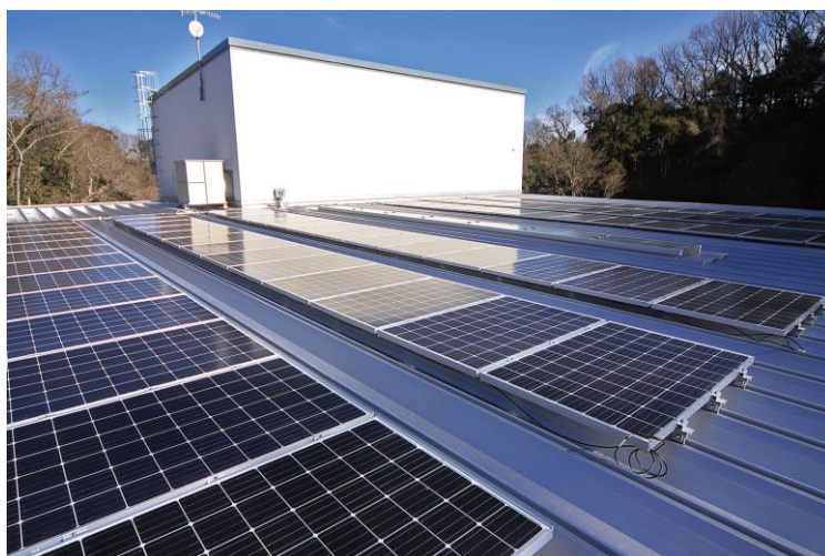
リサイクルセンターの太陽光パネル
