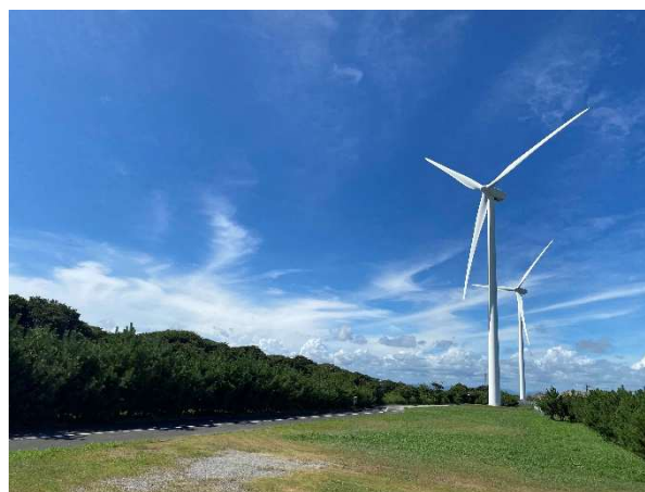
コスモエコパワー(株)が運営する風力発電設備
