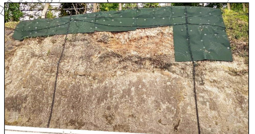
法面の劣化により崩落が発生。応急処置で対応している。
