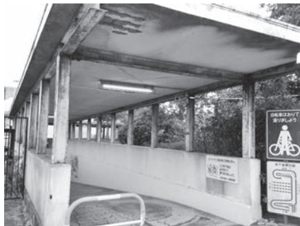
さびの目立つ地下道入口
