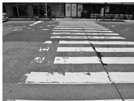
駅前の路面状況
