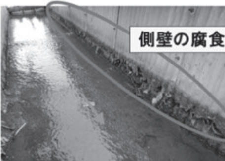
壁面の腐食等が見られる現状
