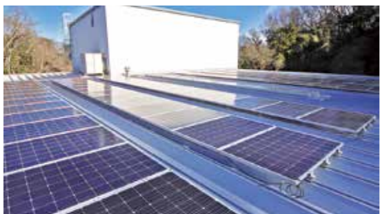
▲屋上に設置された太陽光パネル
