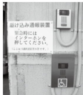
▲駆け込み通報装置
