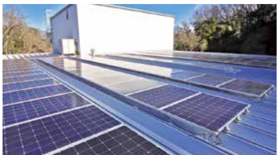
▲屋上に設置された太陽光パネル
