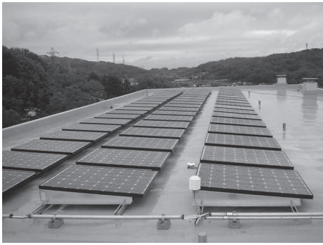
▲太陽光発電設備 (国府中学校)
