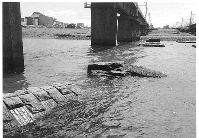
倒壊した馬入川橋脚
