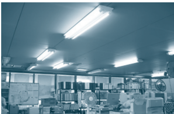
一部LEDになった本庁舎3階の照明器具
