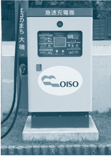
役場駐車場の急速充電器
