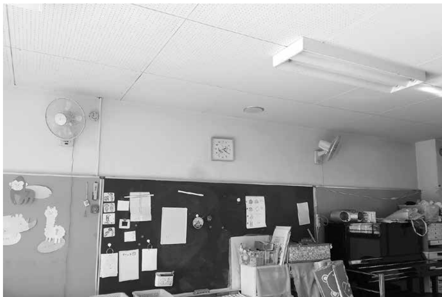
現在は扇風機が設置されている
