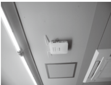
庁舎内に整備されたWi-Fi設備
