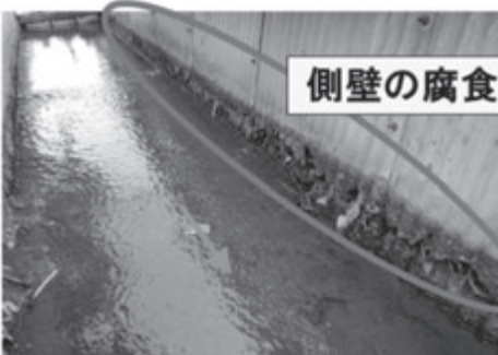
壁面の腐食等が見られる現状
