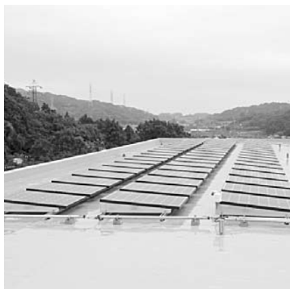
太陽光パネルを設置している国府中
