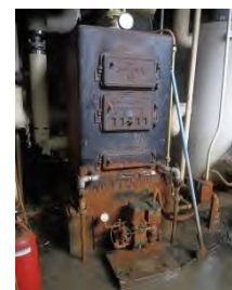
写真 62 アサヒボイラー (2019 年撮影)
