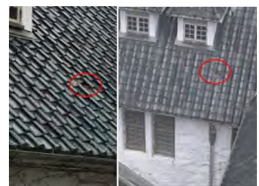
写真 59 一部落下した屋根瓦 (2019 年撮影)
