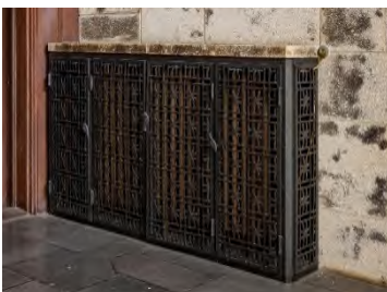
写真 60 温水ラジエーター (2019 年撮影)
