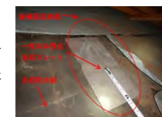
写真 52 北側屋根に残るスレート材（2019 年撮影）
