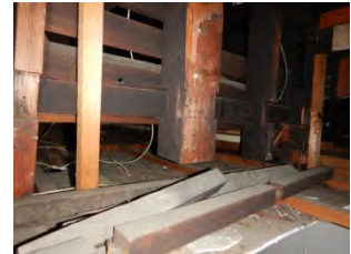
写真 48 間仕切り改造による柱切断（2019 年撮影）
