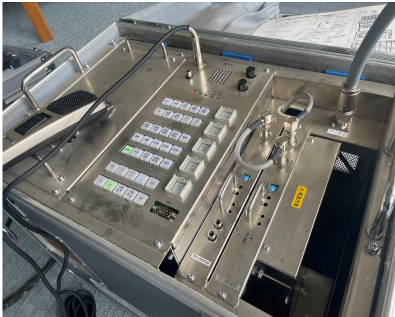
非常用可搬型防災行政無線
